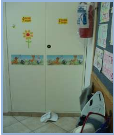
ארון חשמל בכניסה לגן ילדים ברוש, חיפה
