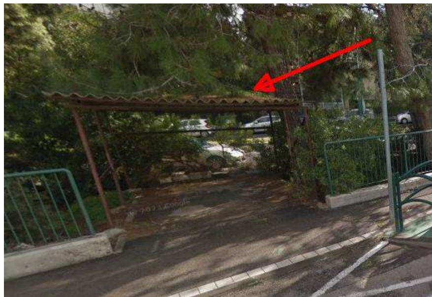
תמונה 16: גג אסבסט מוכרז כמפגע אסבסט בחיפה
